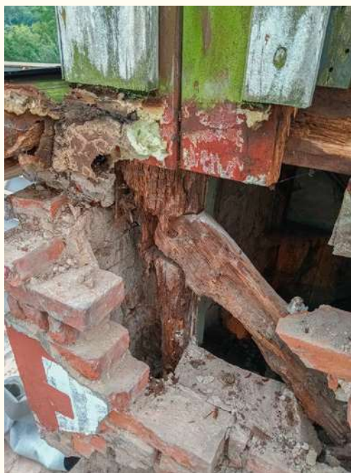
Enorme Schäden am hölzernen Gefüge des Glockenturms, Aufn. 2023 – © Oliver Steen
